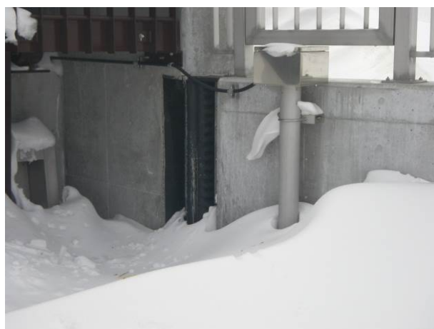
写真-10 大津樋門 扉体、戸当り積雪状況
