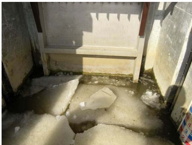
写真-12 十勝太樋門 扉体凍結状況
