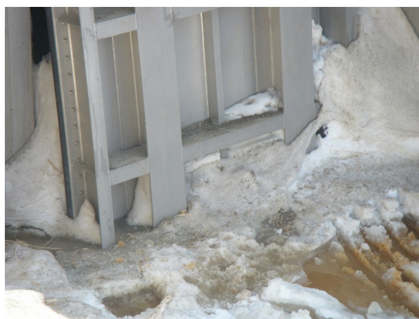
写真-11 幌岡樋門 扉体凍結状況
