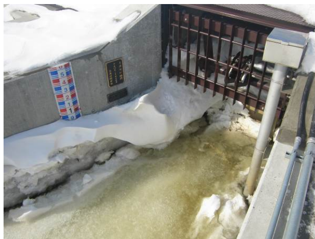
写真-9 大津河口樋門 積雪状況
