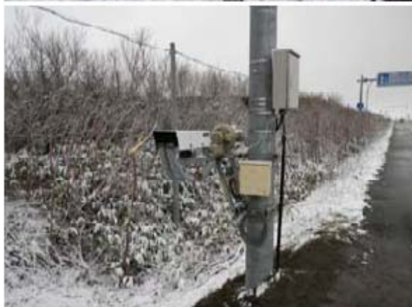
図 69 計測機器設置状況 (上/測定位置(0)、中/測定位置(1)、下/測定位置(2))
