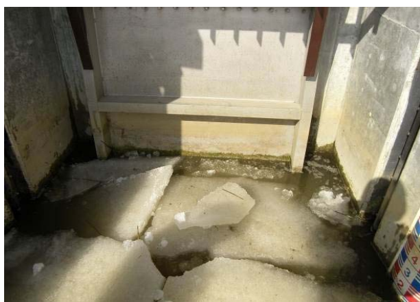
図-30 門柱レスゲート 扉体凍結状況②
