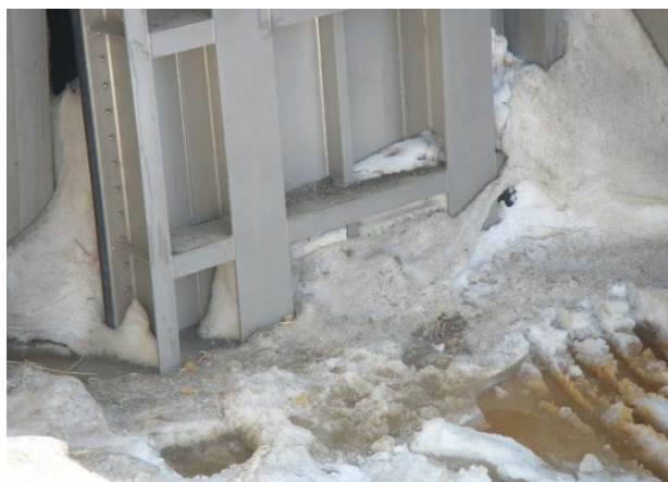
図-29 門柱レスゲート 扉体凍結状況①
