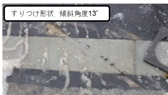
写真11 縁石の損傷状況 (ホイールローダ)
