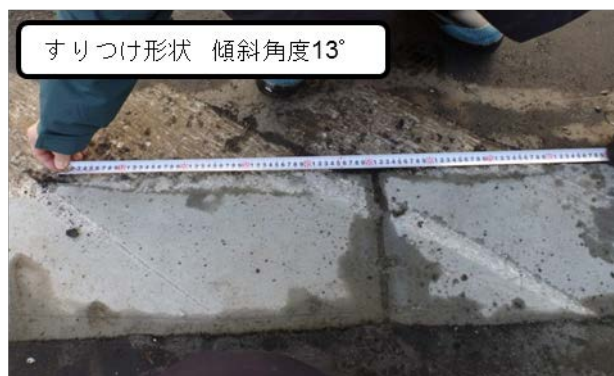
写真 13 縁石の損傷状況（モータグレーダ）
