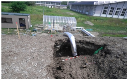
写真-7 H26 実験 C ダクト脱落状況 (7/14)
