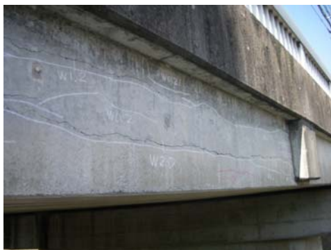
図-1.1 ウェブ水平ひび割れの事例
