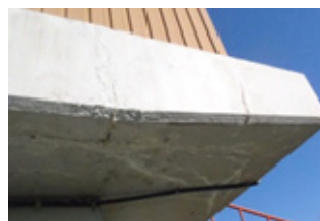
ひび割れとエフロレッセンス
