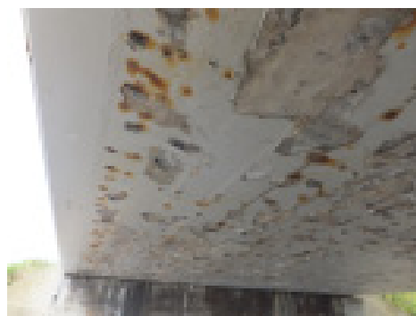
図-2.1 道路橋コンクリート床版の不具合事例
