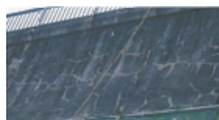
モルタル面のひび割れ
