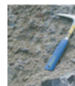
モルタルの土砂化
