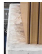
沈下ひび割れ
