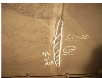
写真-1 目地周辺のうき
