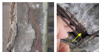
写真-3.2 損傷状況
