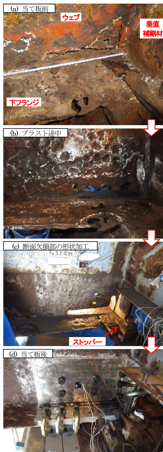
写真-8 断面欠損と応急的な当て板補強の施工状況 (いずれも上流側から撮影) 4)
