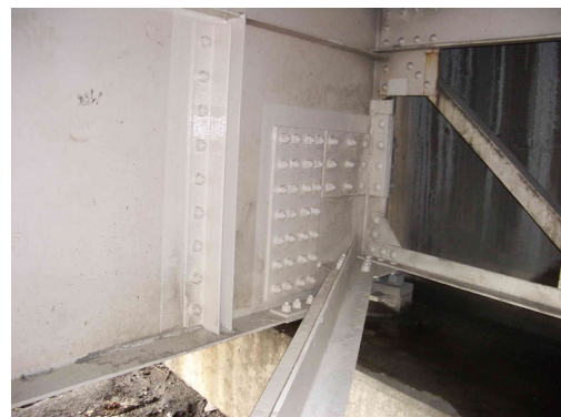
写真-7 部分的な部材取替えの事例 3)
