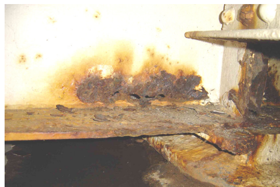
(b) 貫通孔を伴う腐食
