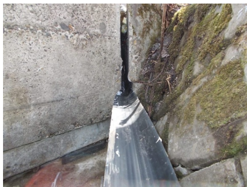
写真-5 単純PC床版橋における試験的な設置 5) ゴム製排水装置を70mmの遊間に挿入
