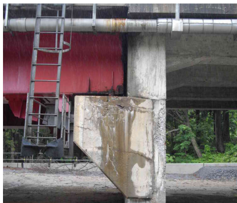
写真-3 橋脚側面のコンクリートの凍害とASRが疑われる劣化事例 5)
