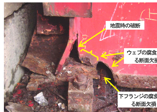
写真-6 鋼橋桁端部の地震時の破断事例 4)
