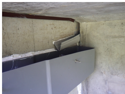
写真-4 単純PCT桁橋における試験的な設置 5) ポリエチレン製排水装置を50mmの遊間に挿入
