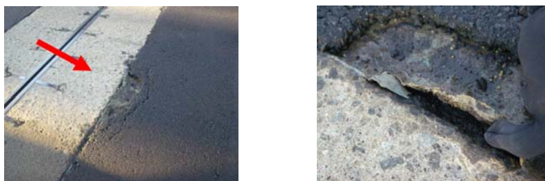
(a) 伸縮装置近傍の防水層のまくれ (b) (a) の矢印の方向からの状況
