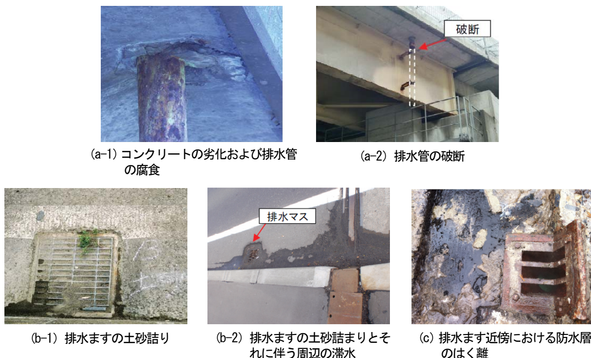
図-32 排水ますに関する代表的な劣化損傷状況
