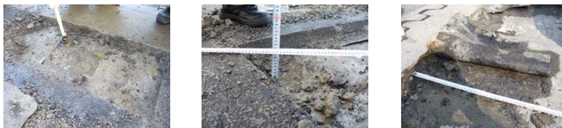
(a) 防水層の接着性の低下
