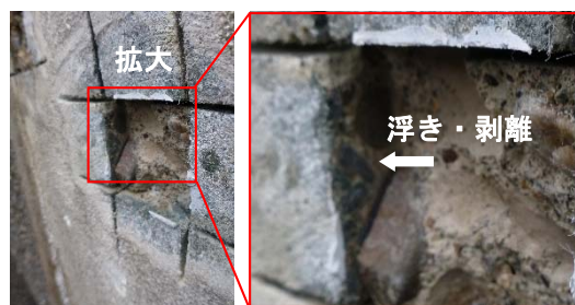
図-96 コンクリート内部の浮き・剥離
