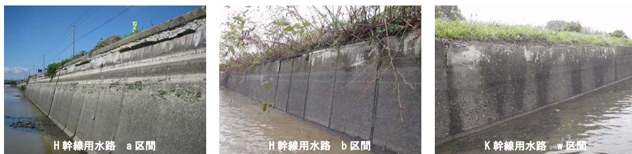
図-17 凍害劣化深さ推定対象の現況
