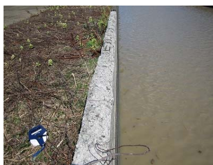
天端のスケーリング
