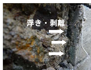
図-97 界面の浮き・剥離
