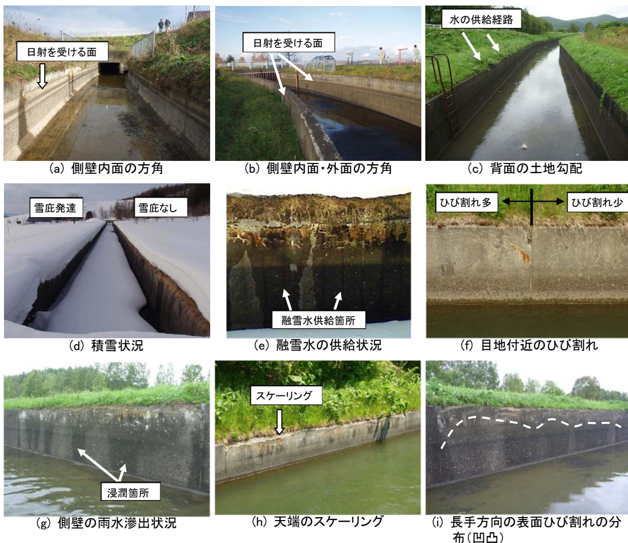
図-13 RC 開水路の凍害診断における目視調査のポイント
