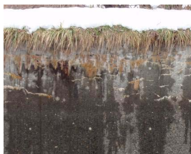
図-9 開水路側壁の凍害によるひび割れ発生状況
