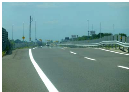
図-7 IC 函渠部での段差状況（終点側から撮影）
