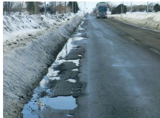
写真-2.6 路肩の堆雪からの融雪水が影響したポットホール
