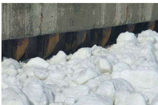
図1 オホーツク海に面した導流堤の鋼矢板の損傷例
