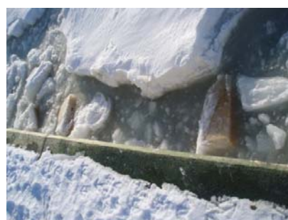
図-14 鋼矢板付近の錆が付着した状態の海水の例
