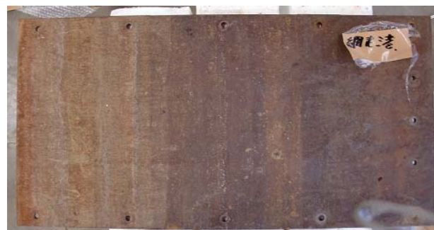
図-49(a) 暴露試験板の撤去後の状況(網走港) (右側が上)
