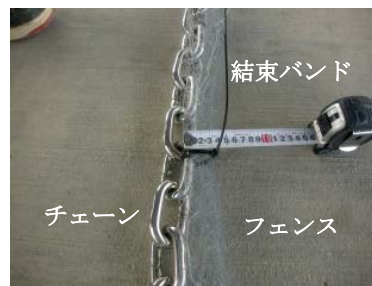
図-23 ウニ侵入防止フェンス
