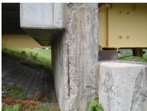
写真-10 凍害が進み表面が欠損している構造物の事例
