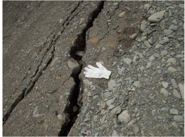
写真-2 春先の小規模な崩壊
