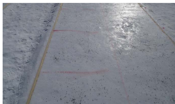
写真-32 構築したアイスバーン状況 (砕石散布)
