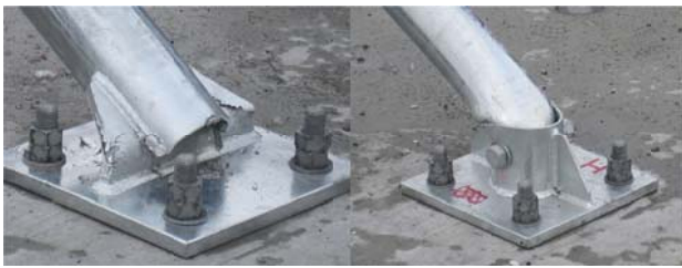
写真22 支衝突後のベースプレートタイプの損傷状況 (左: 内リブタイプ、右: 外筒タイプ)
