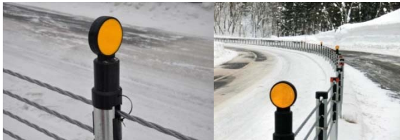
写真 5 ゴム製デリネーター（一般国道 275 号）
