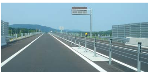
写真23 帯広広尾自動車道の複合構造函渠工に設置されたベースプレート式中間支柱
