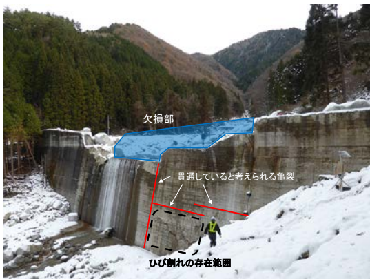
図-5.2 南梨子沢堰堤のひび割れ位置
