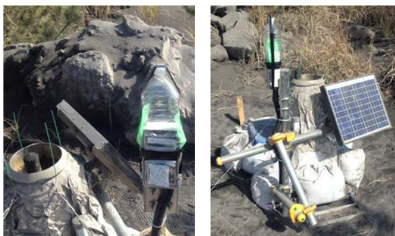
図-2.2 通信端末設置状況 図-2.3 通信端末保護状況
