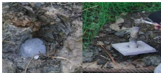
写真-5.2 アンカー破断状況
