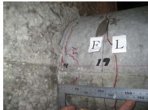
写真-4.3 杭の抜け出しの状況 (-5 \delta_y 時)
