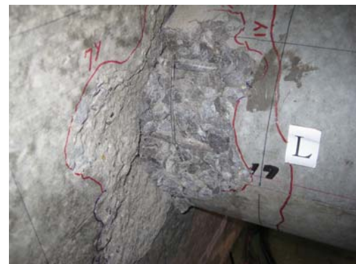
写真-4.4 F杭のスパイラル筋の破断状況 (-8 \delta_y 時)
