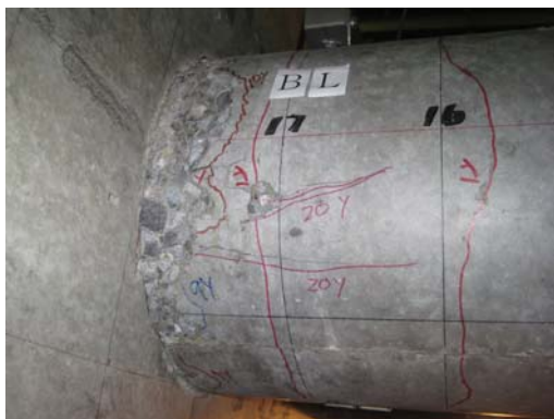
写真-4.6 縦方向のクラックの発生状況 ( 20\delta_y 時)
