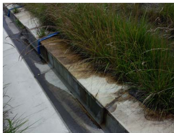
写真-7 排水マット設置位置の間からの湧水状況
