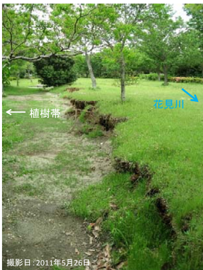
写真-3.1 花見川緑地における地震後の噴砂および地表面の沈下の状況
