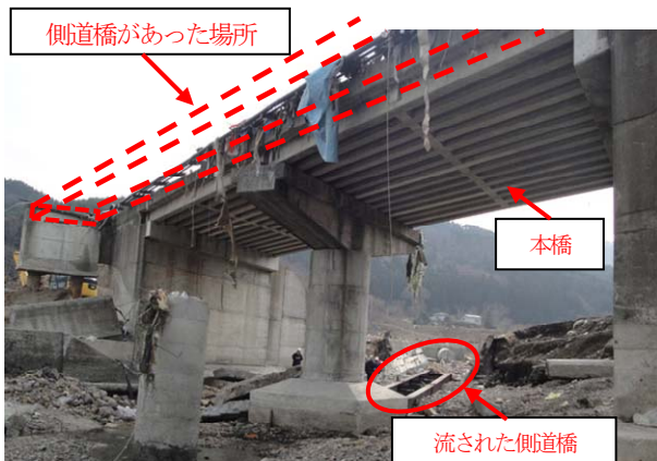
写真-7.1 側道橋は流出したが、本橋は流出しなかった例 (浪板橋)
