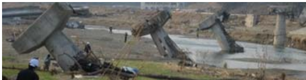
(a) 橋脚の倒壊も伴って機能損失した橋
