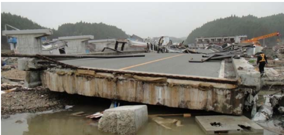
写真-2.4 橋桁が裏返しにならずに流出した橋梁
