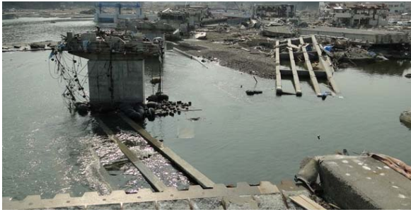
写真-2.3 橋桁が裏返しになって流出した橋梁
