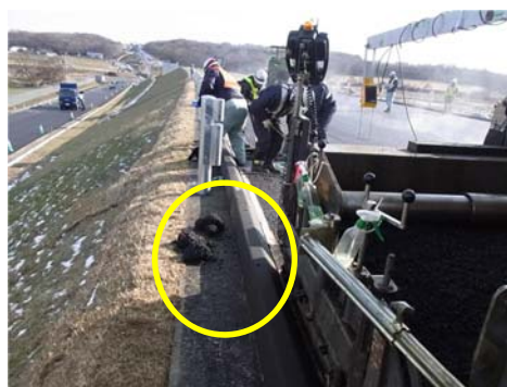
写真-1-2 敷均し作業時に発生したAs塊
