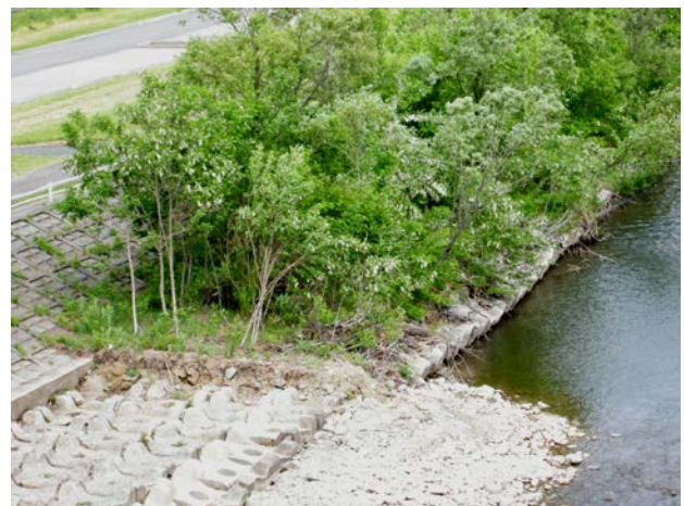
図-2.18 陸化した根固工に繁茂した樹木（セグメント1 今回の調査対象外の箇所）
