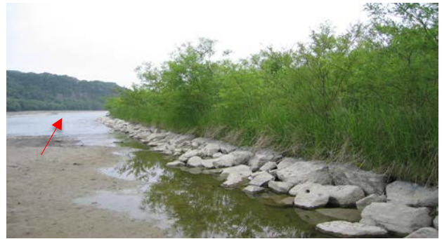
図-2.1 低水護岸の割石の干上がり
