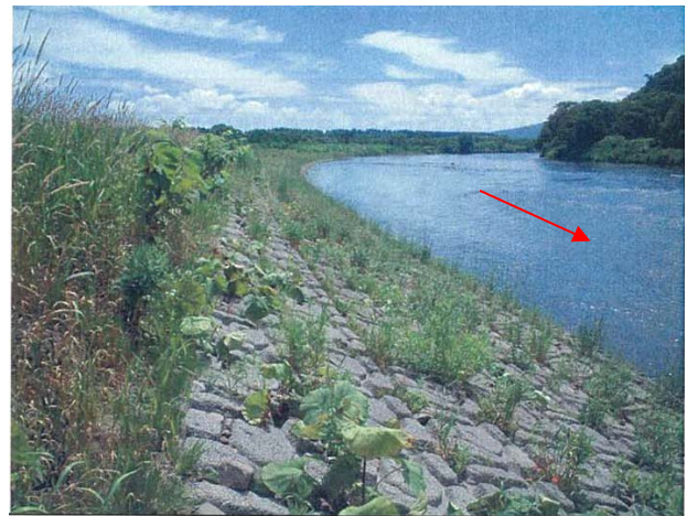
図-2.10 覆土流出後の連節ブロックの隙間からの植生生育（セグメント2-1）
