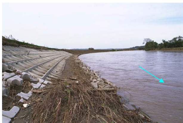
図-2.12 覆土の流出した低水護岸 (セグメント2-1)
