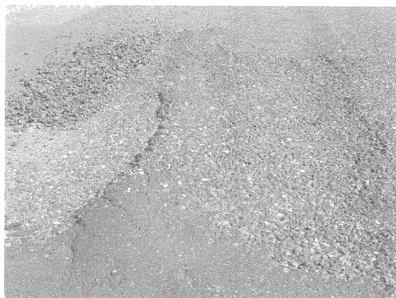
写真-1 側方流動発生地点
