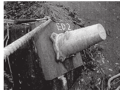
図-7 頭部キャップからの防錆油漏れ
