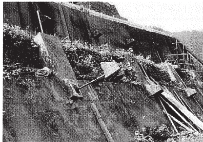
図-5 アンカー頭部の突出
