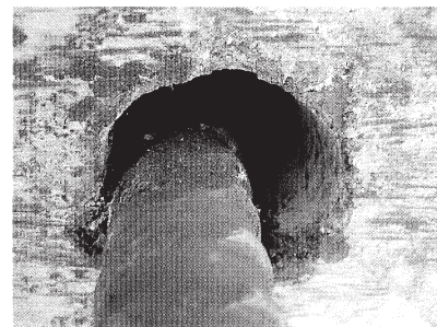
図-8 頭部背面のテンドンの腐食
