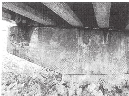
図-1 ASRにより多数のひび割れが生じた橋脚
