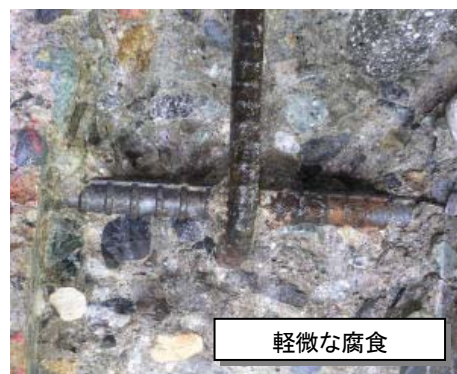
図-13 PC 橋 PC5 の鉄筋腐食状況
