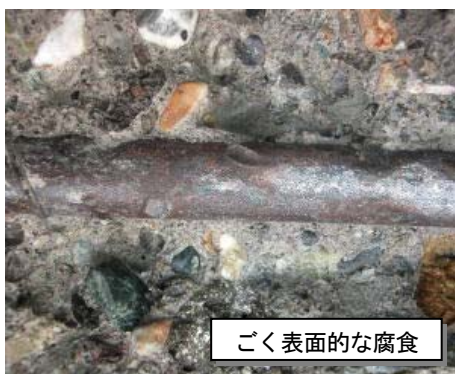
図-12 RC 床版橋 RC5 の鉄筋腐食状況
