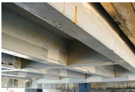
図-1 塩害による損傷の例
