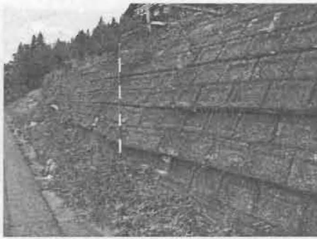
図-2 ブロック積み擁壁の被害例
