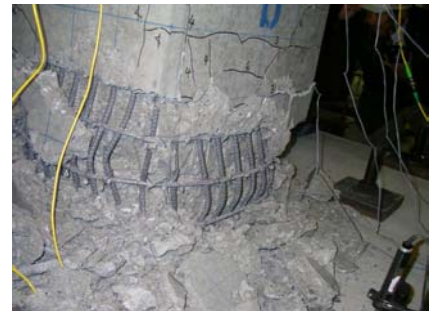
写真-2 ケース8加振後の状況 (MB角部)
