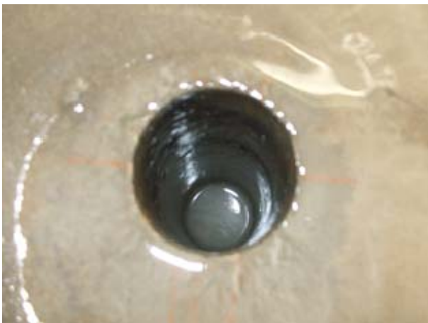
写真-3 コア抜き後
