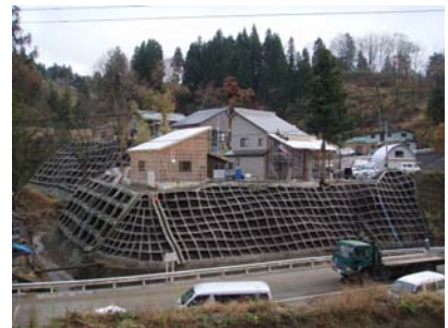
写真-5 朝日川山中地すべり全景を示したものである。基岩は、荒谷層の泥岩である。
