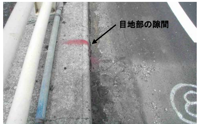
図-20 SI 橋の舗装目地部の隙間
