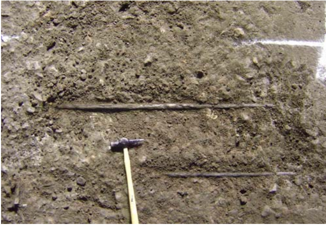
図-38 床版上面の鉄筋腐食と上面かぶりの剥離 (補修のため、鉄筋下まではつったところ)
