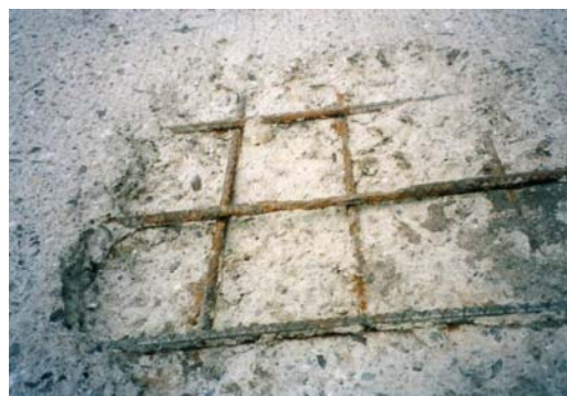
図-1 RC 床版上面の腐食事例
