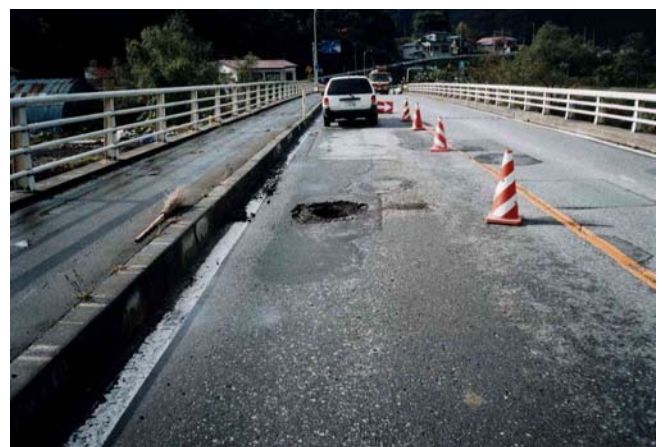
図-42 抜け落ちた箇所周囲の路面状況 9)
