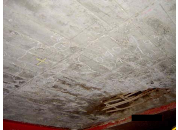
図-41 抜け落ちた箇所周辺のひび割れ状況 (左上の部分はひび割れが出ていなかった)
