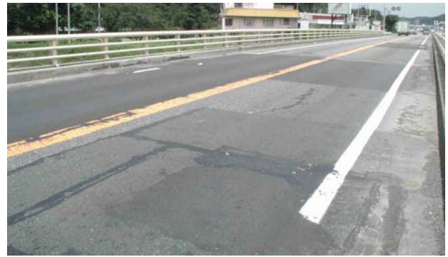
図-19 SI 橋補修前の部分的な舗装修繕の状況
