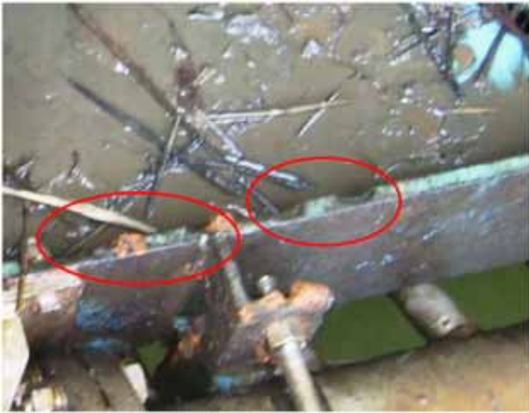
写真 - 5 主桁フランジの腐食
