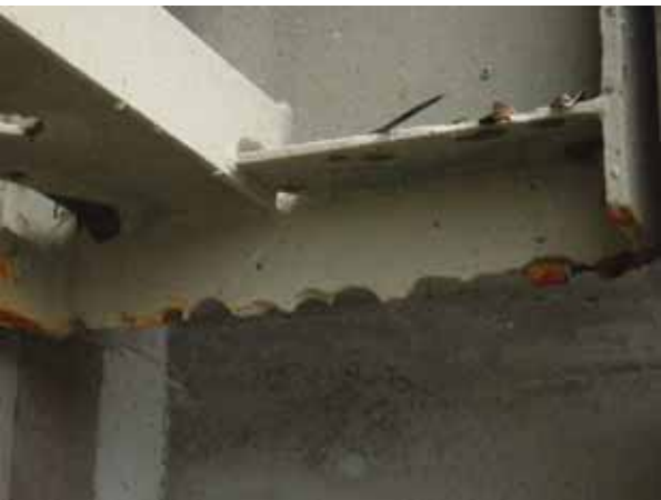
写真 - 6 縦端桁下部の腐食
