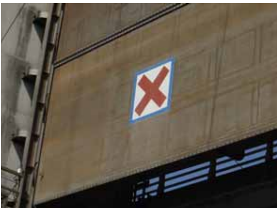
写真 - 1 スキンプレートの発錆
