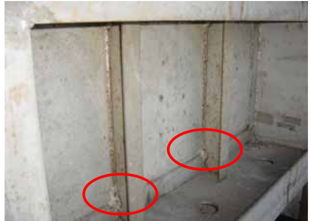
写真 - 2 溶接部の腐食（補修済み）
