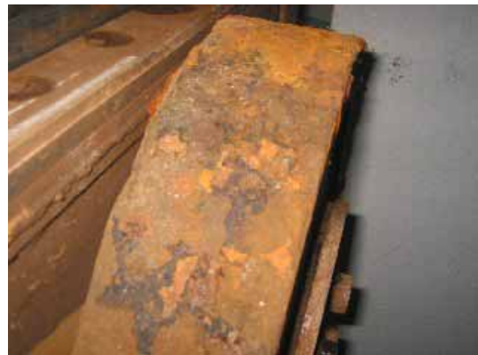
写真 - 4 主ローラの腐食
