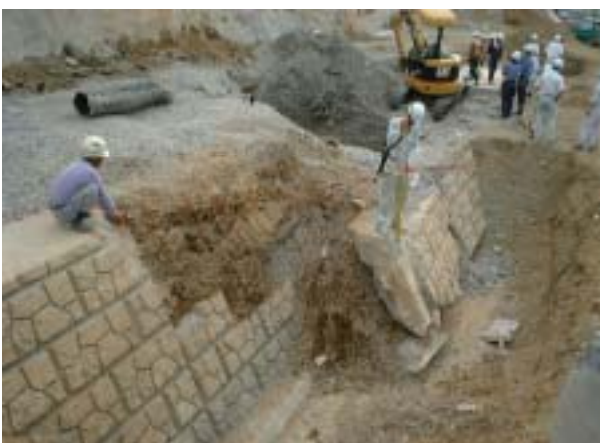
写真 3 下段の大型ブロック積みめのせん断破壊状況
