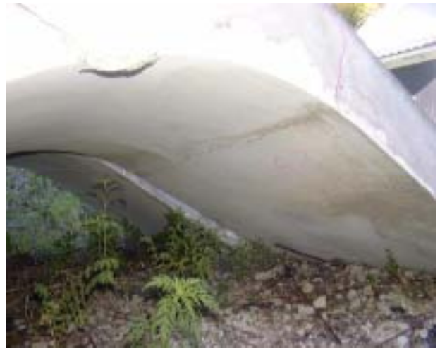
写真 4 崩壊しなかった擁壁の底版クラックの状況
