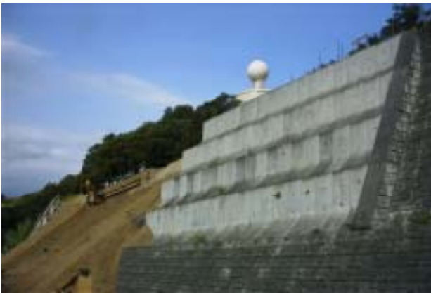
写真 2 崩壊しなかった区間と崩壊した区間
