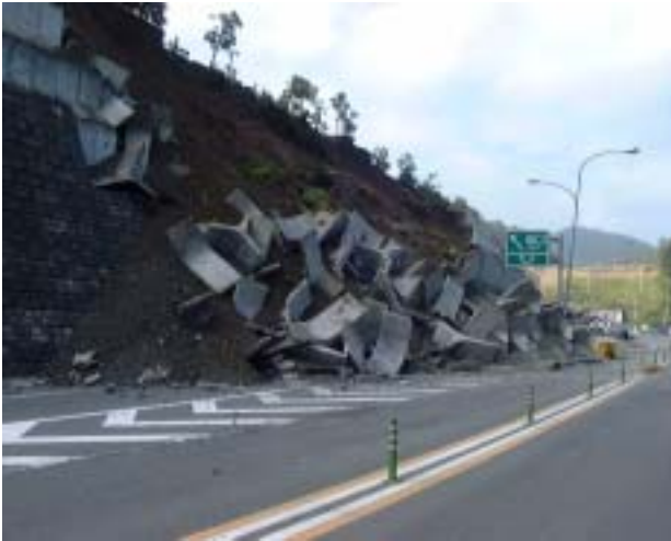
写真 1 逆Y擁壁の崩壊状況
