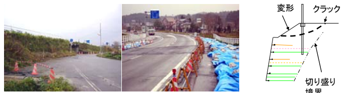
図-2.2b No.4 被害状況
