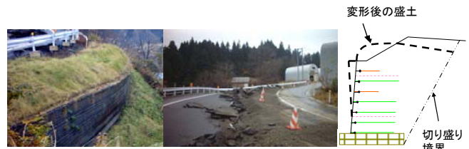
図-2.2a No.3 被害状況
