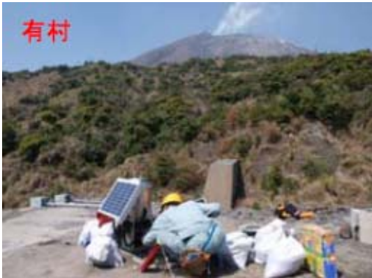
図-10 桜島有村川への自動降灰量計の設置状況
