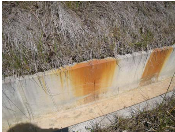
図—3 赤水流出の状況
