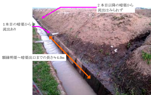
写真-1 輪換畑の排水路法面上における浸潤線（平成16年5月12日、文献 2) より引用）
