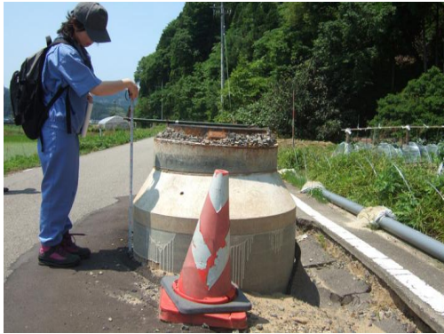
図-3 門前②の被災状況
