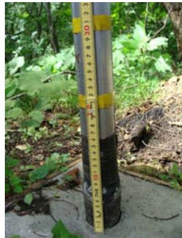
図-10 H20B-3(砂詰め孔)の浮き上がり状況
