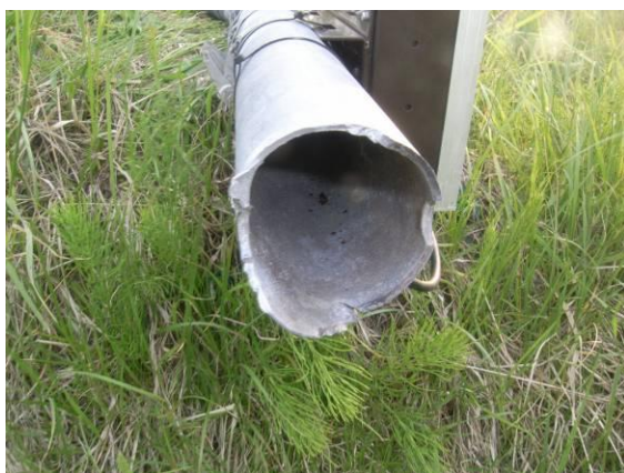
写真-Ⅲ-2 損壊箇所断面状況
