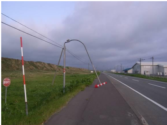
写真-Ⅲ-1 固定式視線誘導柱損壊状況
