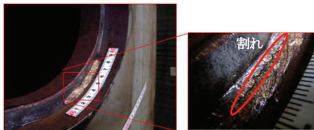
(b) 組立溶接の割れの発生
