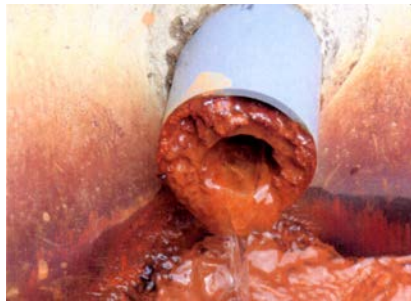
写真-3 閉塞した集水管A
